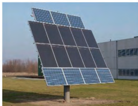
Afb. 54: Zonne-energie met volgsysteem in Greenbridge ( argus.powermonitor.be )
