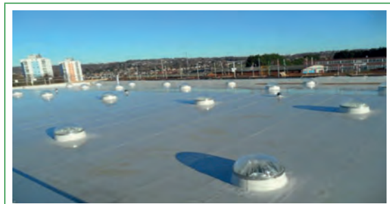
Afb. 47: LightCatchers of zonlichttunnels – Theaklen Drive
