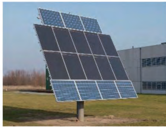
Fig. 54: Système de suivi solaire à Greenbridge ( argus.powermonitor.be )
